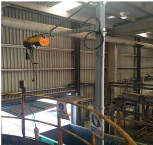
Detalle Maquinillos de Elevación Instalado
