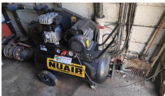
Compresor Neumático Zona Depuración
