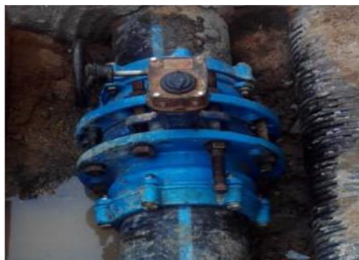
Detalle Parte Afectada
