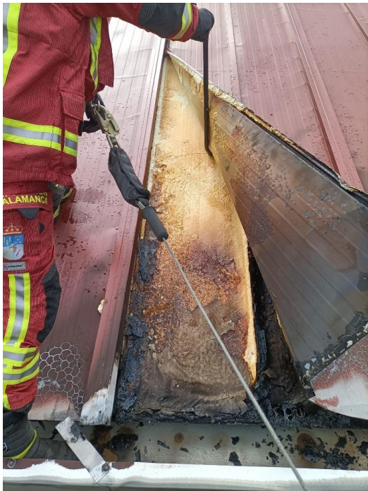
Imagen 3: Detalle de la afectación de la cubierta
